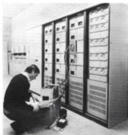
Inbedrijfstelling licht sterkte regelaars, back-up systeem en aardfoutbewaking van één van de baanstations voor een start- en landingsbaan NV Luchthaven Schiphol.
